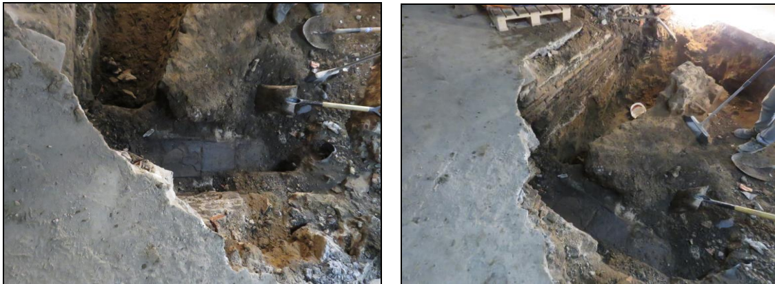
Dues vistes de la claveguera UE 117 i les restes de la claveguera UE 115
